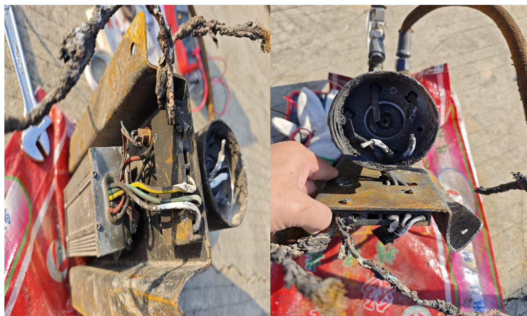
图 8、9 倒气泵电源线及电源接线盒
