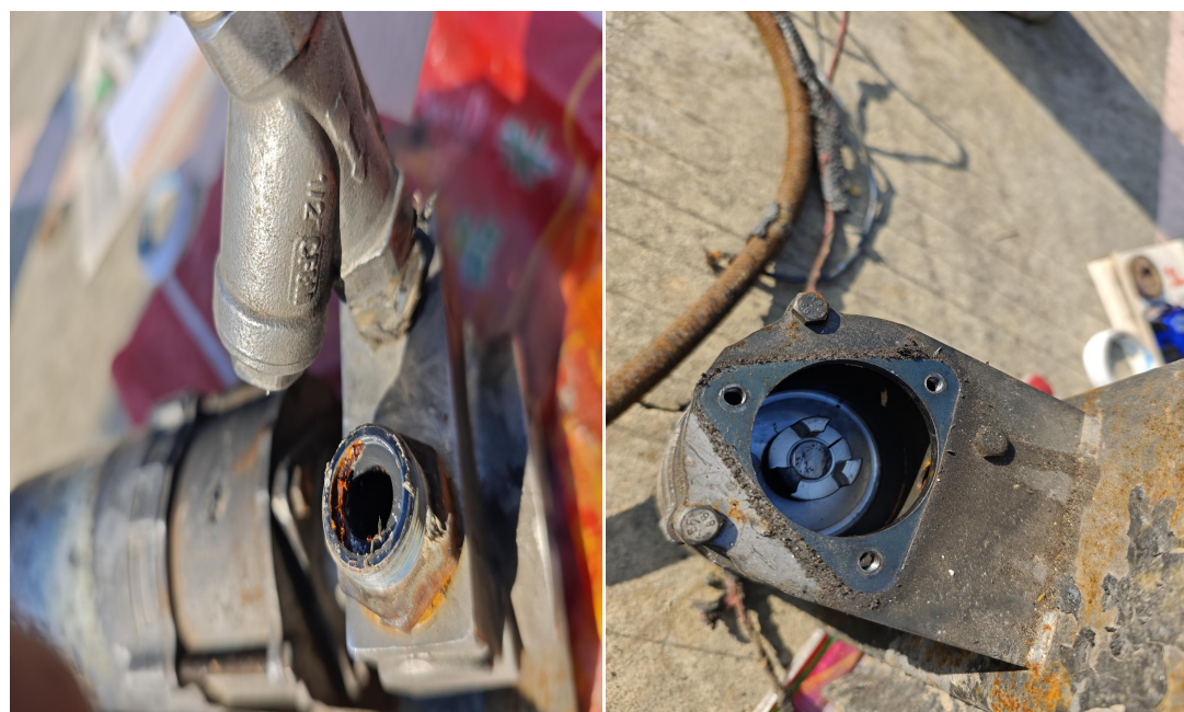
图 12、13 倒气泵出口接管及联轴器
