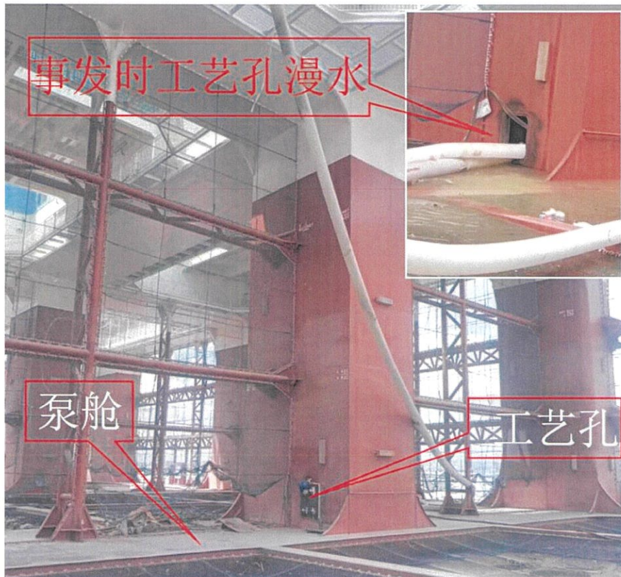
图3 “普盛海洋牧场6号”主甲板及泵舱情况
